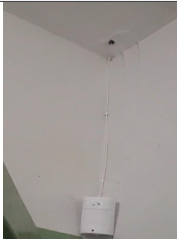
Vazamento no teto pelo sistema filmagem
