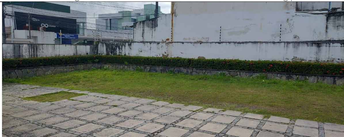
Necessidade de pintura no muro do terreno
