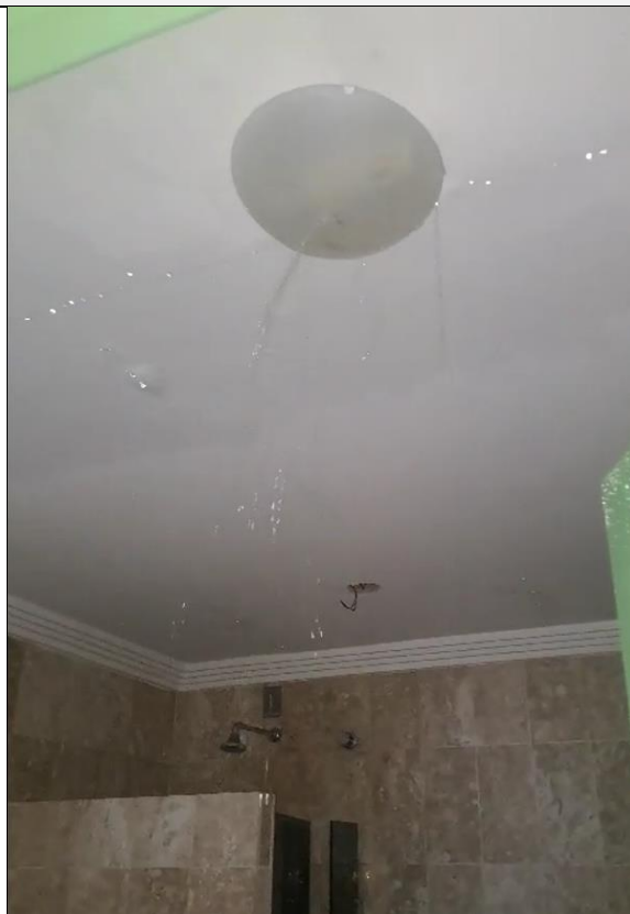
Vazamento no teto pelo sistema de iluminação
